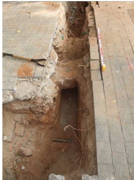
10. Obertura de la rasa i vista de serveis d'aigua i fibra òptica.
